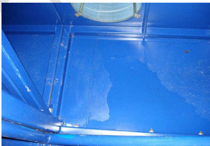
Рис.3.67. Влага на чистой стороне КВОУ за фильтрами
