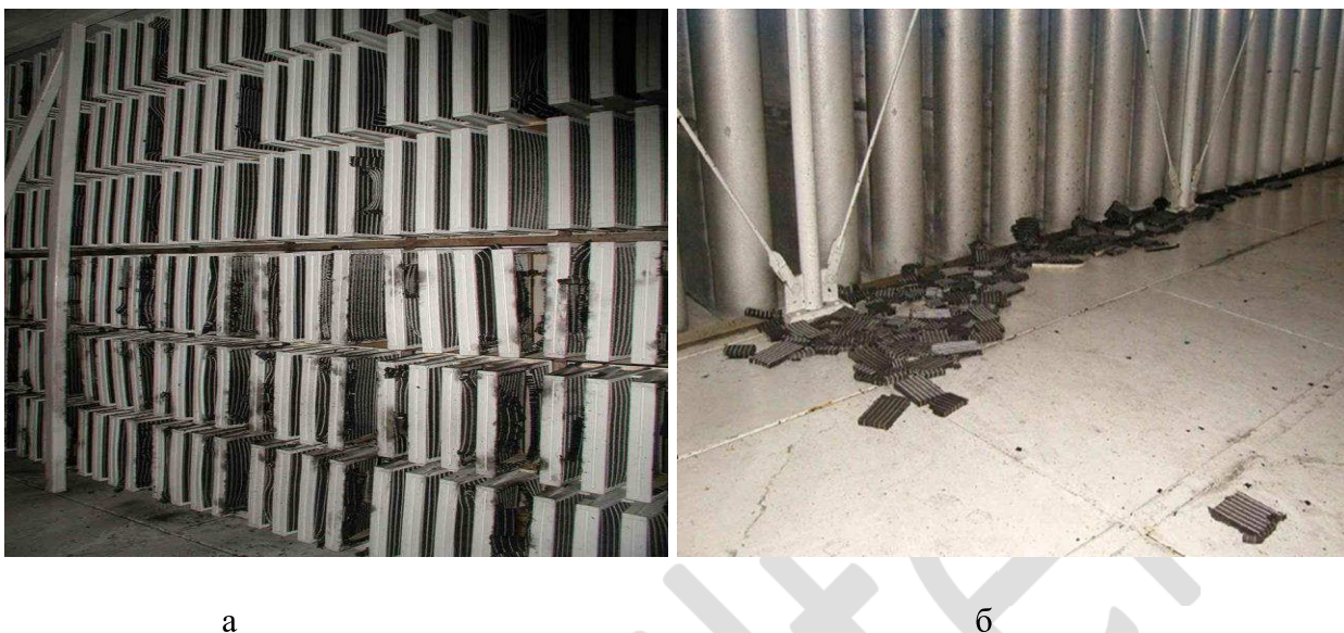
Рис. 3.73. Массовое разрушение фильтров: а- в КВОУ; б- у глушителей шума
