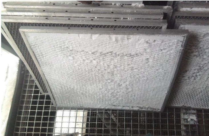
Рис.2.36. Занос снегом фильтров КВОУ ГТУ
