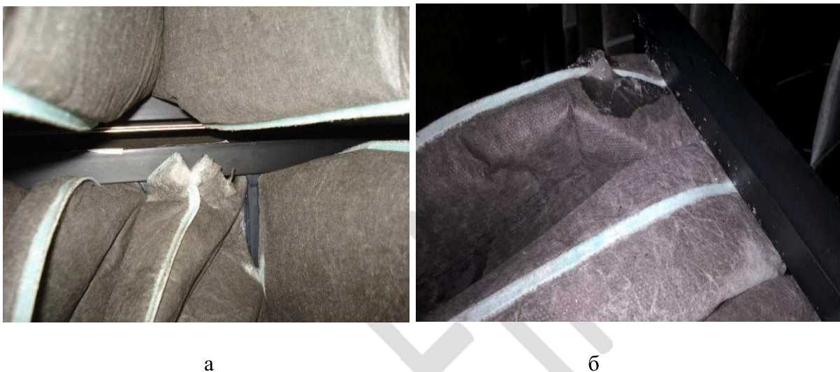
Рис.3.57. Повреждение карманов фильтра: а- под тяжестью снега; б- льдом
