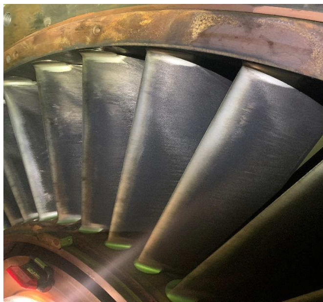
Рис.2.67. Загрязненное состояние лопаток ВНА ГТУ
