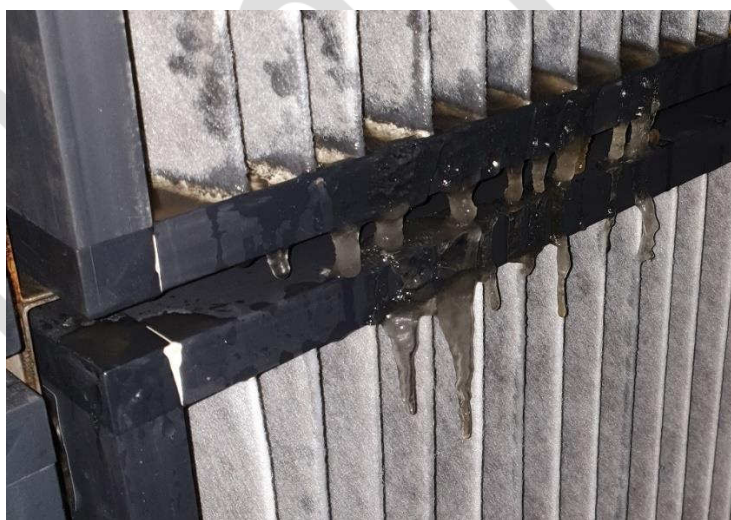
Рис.2.23. Обледенение панельного фильтра
