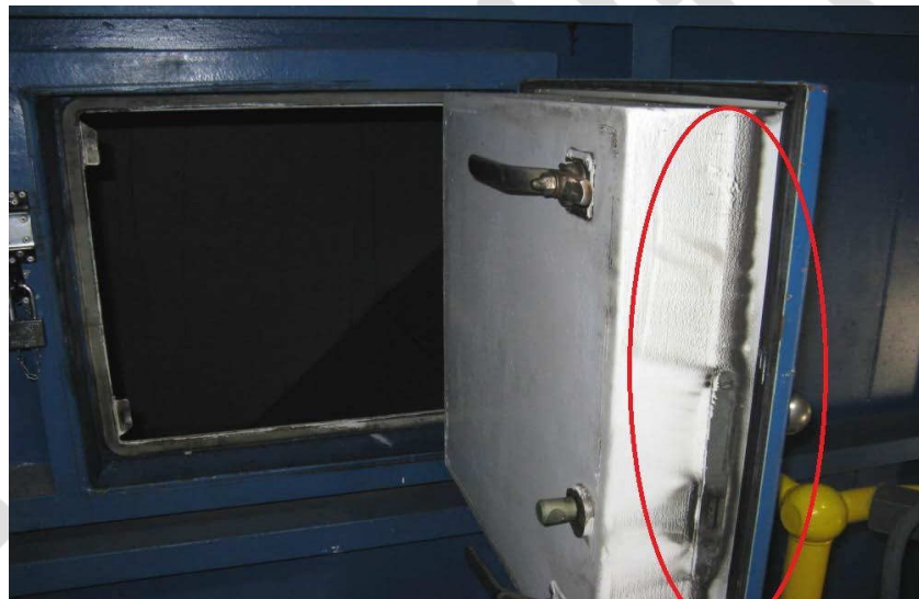
Рис.2.65. Подсос грязного воздуха из машинного зала в воздуховод к ГТУ
