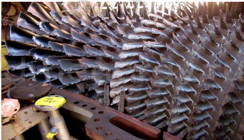
Рис.1.9. Повреждение лопаток осевого компрессора ГТУ ( https://goo.su/QHo11 )
