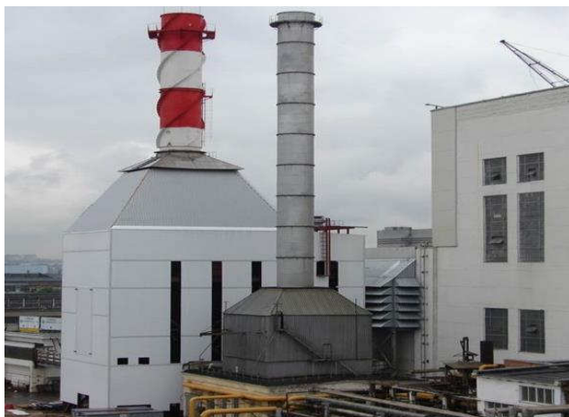
Рис. 2.37. КВОУ ГТУ ТЭЦ перед стеной котла утилизатора ( https://clck.ru/33XTga )
